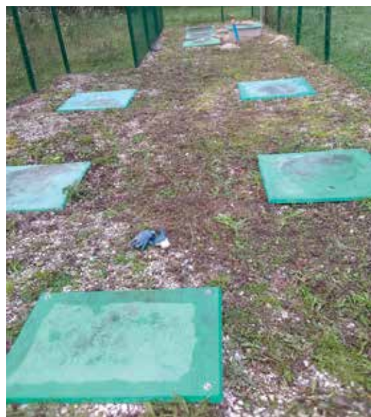
STATION D'ÉPURATION ACTUELLE LA PERRINE
